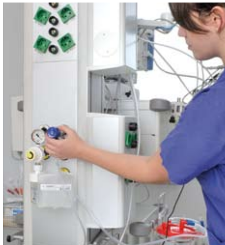
Versorgungssäule mit O2 und Vakuumregler
